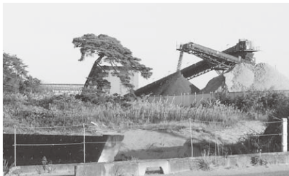
約70億円をかけて建造されたベルトコンベアー(東松島市)
