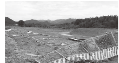
仮設資材 台風被害にあった
