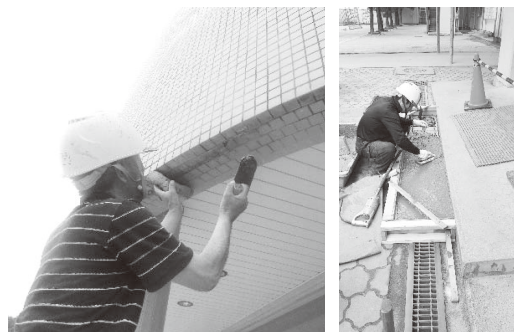
老朽化がすすむ教育施設は、小修繕工事の“宝庫”です
