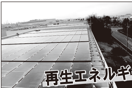
滋賀県 ひのきが丘工業団地内 太陽光発電所 (400kW)
